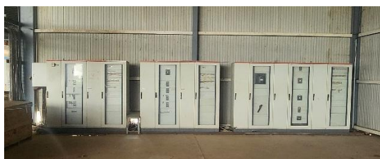
工业电控与配电柜
