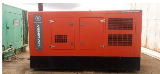
125千伏安 HIMOINSA 发电机
