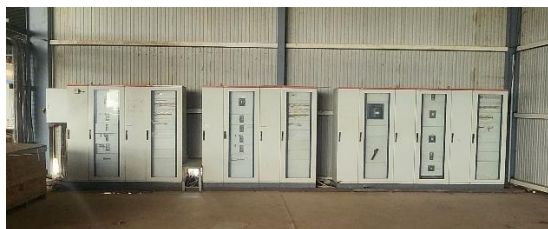
工业电控与配电柜
