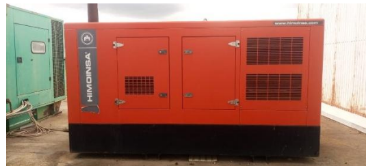
Generator HIMOINSA de 125KVA
